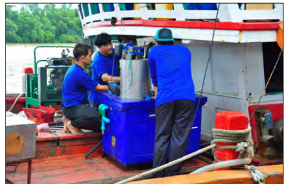
การติดตั้งระบบแช่เย็นแบบเกล็ดหิมะ ในพื้นที่จังหวัดชุมพร
