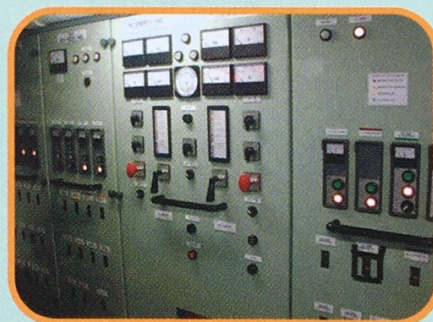
▲ แผงสวิตช์ควบคุม
