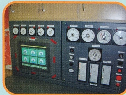
▲ แผงควบคุมเครื่องจักรใหญ่
